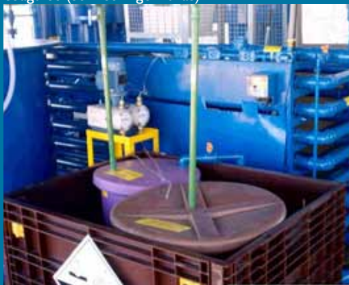
Figura 4 – Floculador – Processo de formação de coágulos (sólidos + gorduras)
