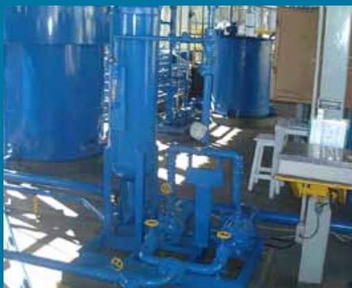
Figura 5 - Captação de ar para suspender os sólidos no flotor
