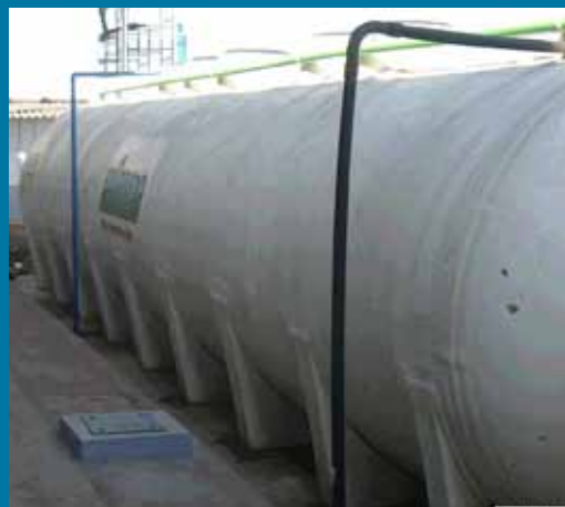
Figura 7 - Tanque Mizumo de tratamento de resíduo sanitário (sistema biológico)
