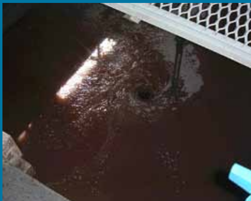
Figura 3 – Tanque de Equalização do Efluente
