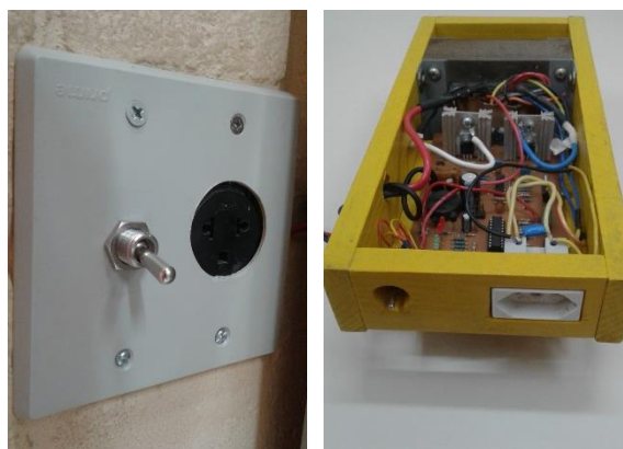
Figuras 05 e 06 – Comutador da sala de desenvolvimento e Inversor
